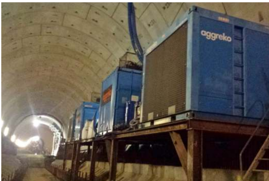
Due impianti frigoriferi installati nella galleria principale
